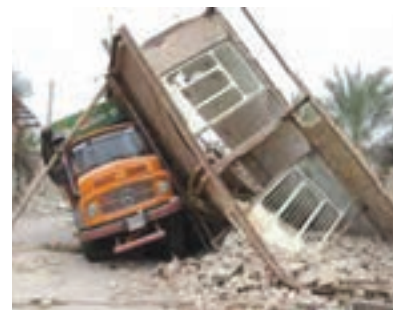
الف) ریزش دیوار در اثر زلزله
