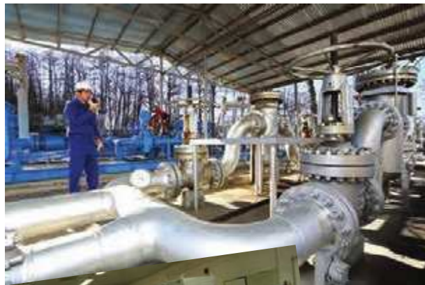
منطقه شمال - ایستگاه فشار شکن لاجیم
