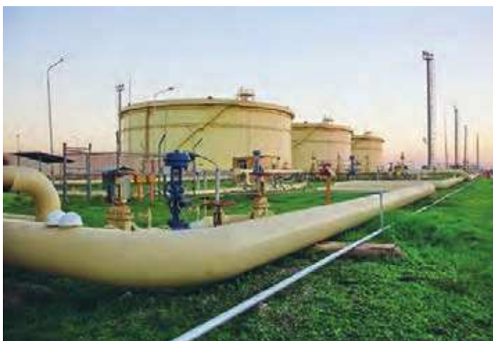
شکل ۲۱- نمایی از خطوط انتقال سوخت
